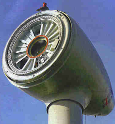
LUFT-KRAFTMASCHINE Die aggressive Seeluft setzt besonders den Rotoren zu. Die Dänen mussten bereits einen Windpark demontieren
